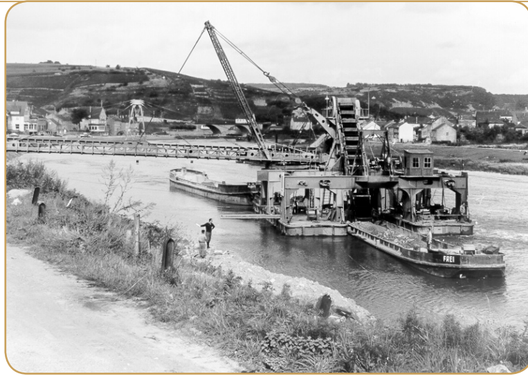
Drague flottante à godets avec tapis transporteur articulé déversant sur la berge gauche à l'amont de Wasserbillig (août 1961).
