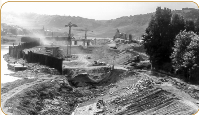
Profilage de la berge à l'amont du pont de Grevenmacher, au fond le chantier de l'écluse.
