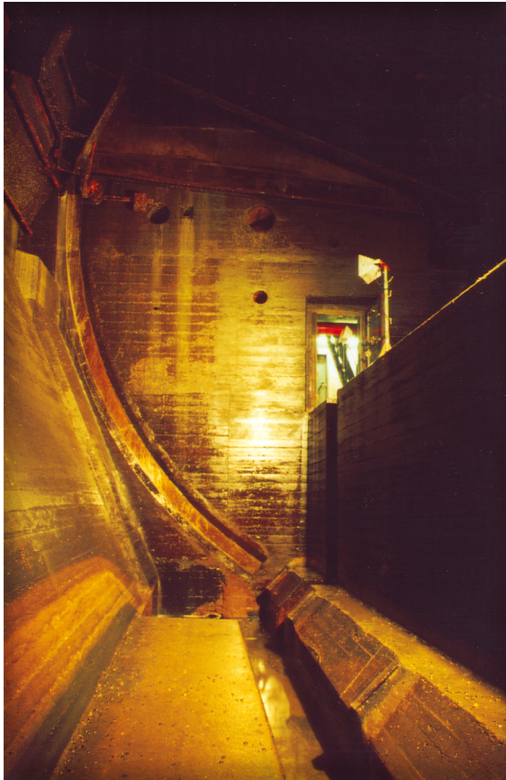
La chambre de vanne mise à sec, la vanne-secteur en position de révision
