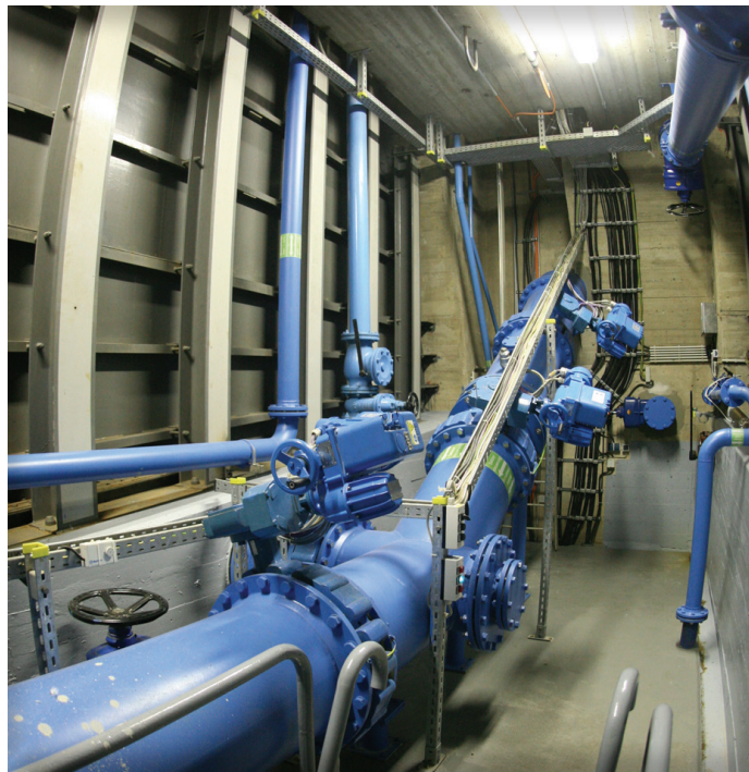
Vue du local souterrain de manoeuvre d'une vanne secteur
