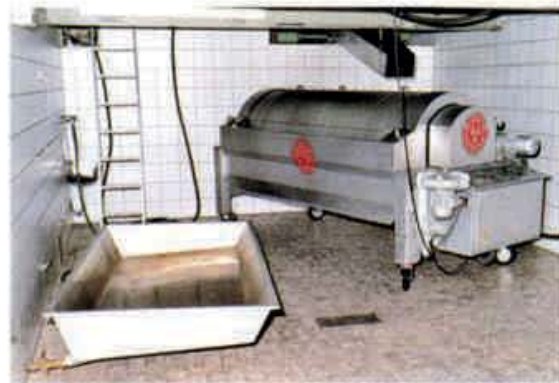
Kellerraum mit Tankpresse
