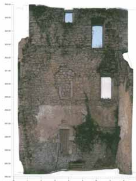
Château de Koerich - Documentation de la zone fortement déstabilisée avant l'intervention
